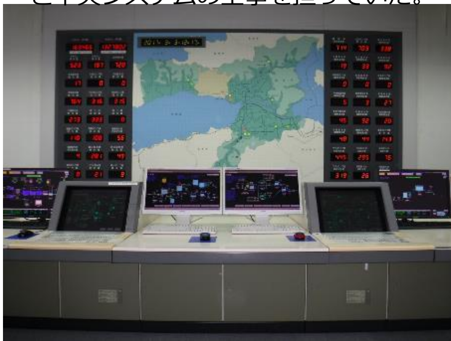
大型制御装置（DCS）の表示装置
